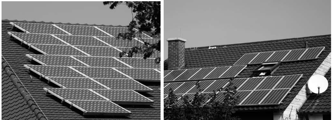
Abb. 8 Unzulässige Anordnung von Solarmodulen, Quelle: Solaranlagen gut gestalten (2013)
